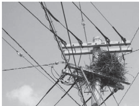
pic 2 電柱営巣状況
